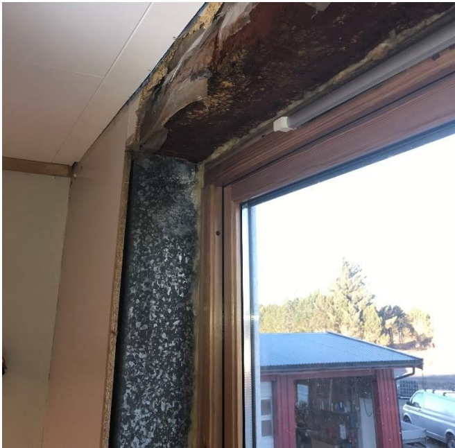
Bilde B 6 - Rustangrep på stål rundt vindu
