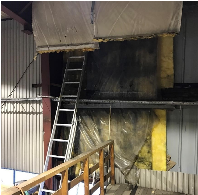
Bilde B 8 - Yttervegg åpnet opp innvendig for registrering av fukt- og rustangrep.
