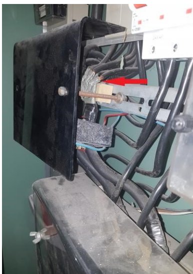
Bilde EL5- Rød pil indikerer eksempel på spenningsførende del med manglende avdekning i fordeling
