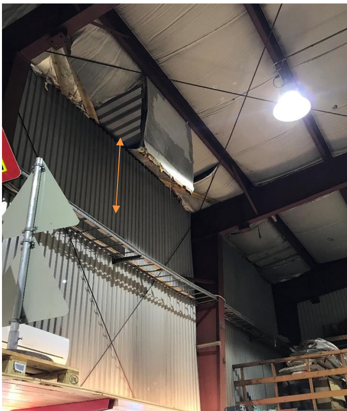
Bilde B 7 - Vanninntrenging fra tak nedover langs innsiden av yttervegg
