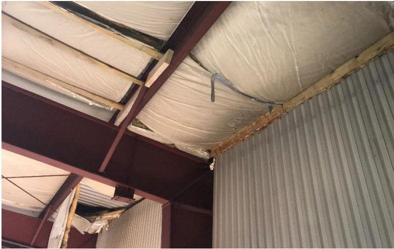
Bilde B 3 - Innvendig tak med isolasjon som er provisorisk hengt opp. Viser også isolasjonsmatter som henger ned.
