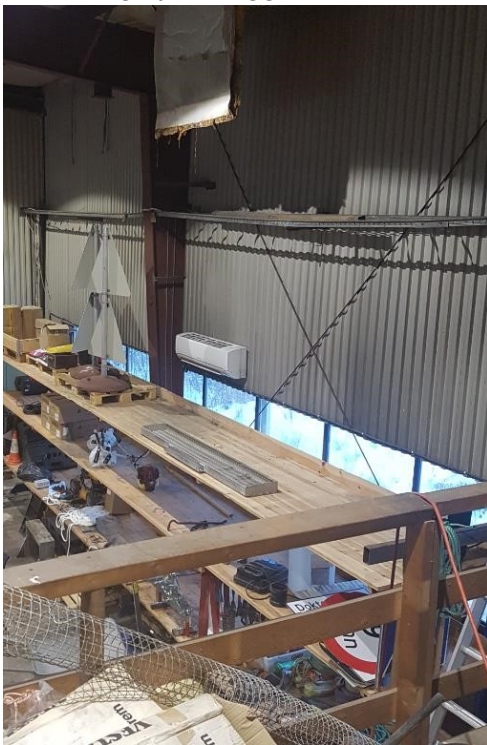
Bilde EL2 - Viser er horisontal kabelbru langs yttervegg
