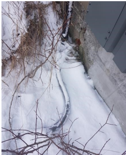
Bilde EL3- Byggets inntakskabel ligger på bakken uten mekanisk beskyttelse
