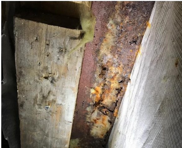
Bilde B 5 - Rustangrep på stålbjelke langs raft på framsiden av bygget. Bilde fra innsiden av bygget.
