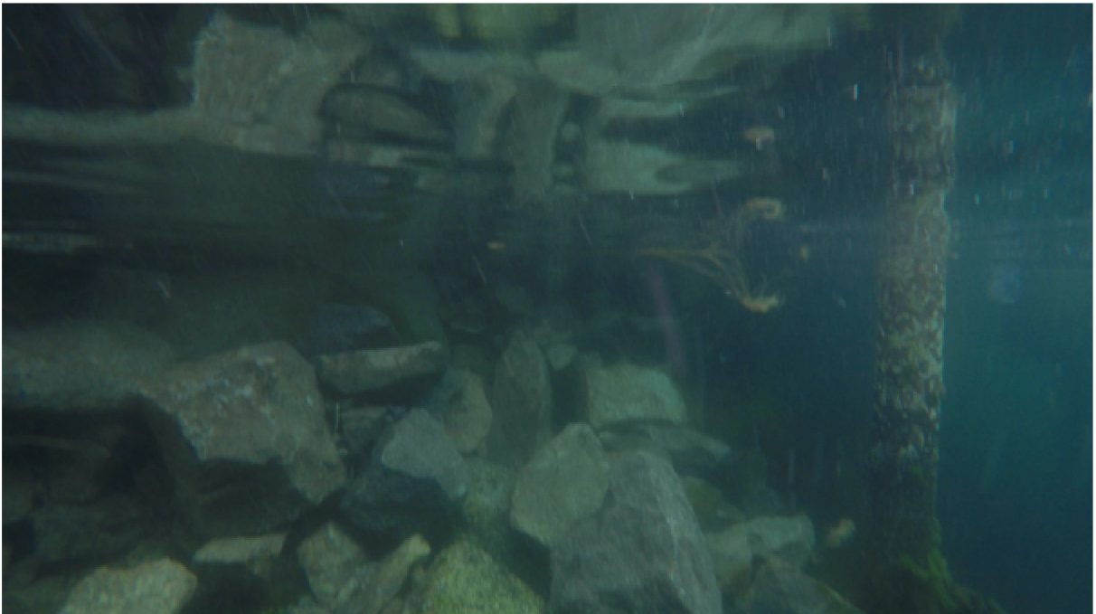
Sett fra siden, støtte er festet (støpt) i topp deksel på kaia, men er ikke festet mot bunn.
