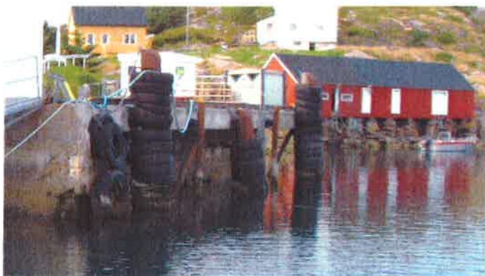
Kai Bogøyvær. Viser dekkfendring og noe lavere midtre fendring.
