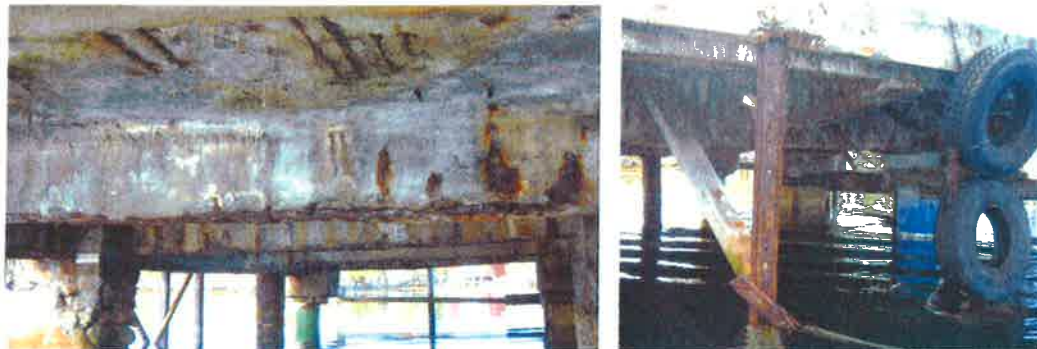
Eksempel på skader på kaias bærekonstruksjoner og fending.
