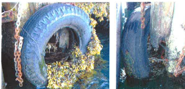
Eksempel på dårlig fendring og bakstøtte for fendring.
