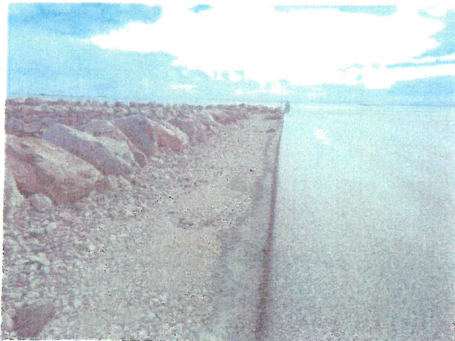
Område mellom asfalt og plastring ikke ferdig.
