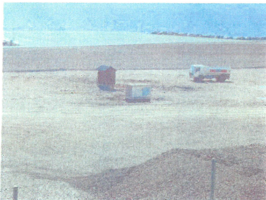
Mangler at fylle opp område rundt Trafo/pumpehus.
