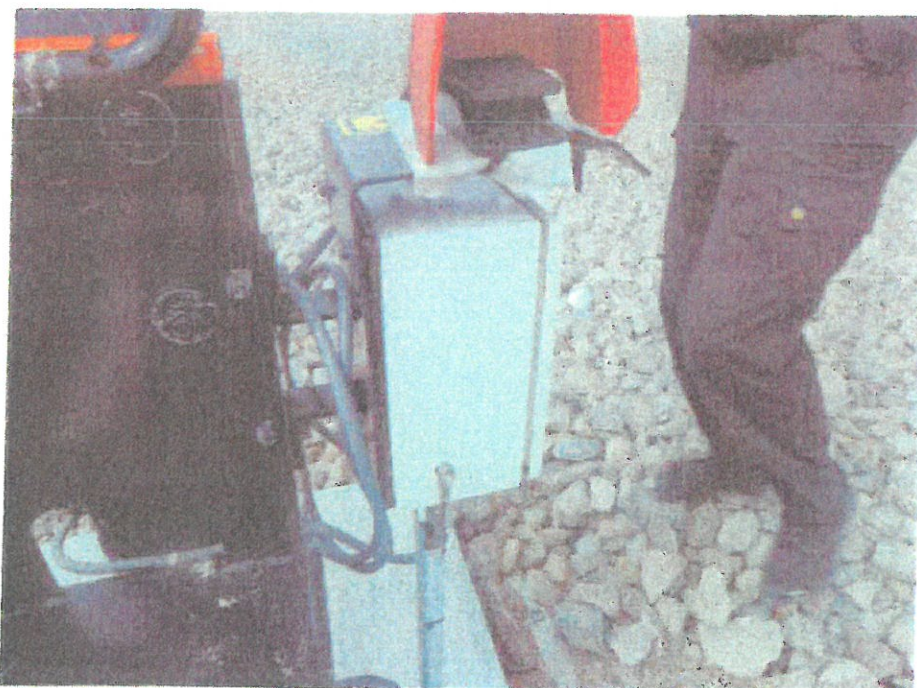
Hengsler på koblingsboks (landpullerer) begynt at ruste.
