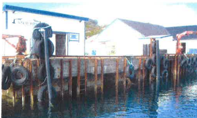
Dekkfendring som mangler mellom vertikalfendring.
