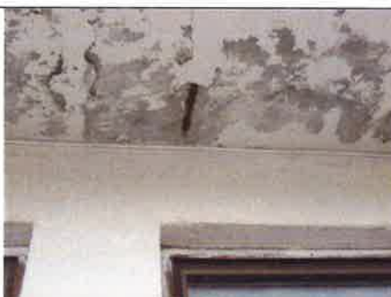
Krakelering og fri-legging av armering
