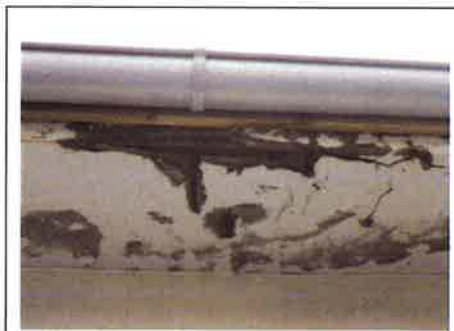
Krakelering og fri-legging av armering
