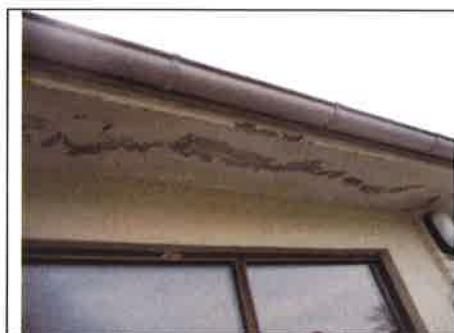
Malingsflass pga fukt, delvis krakelering
