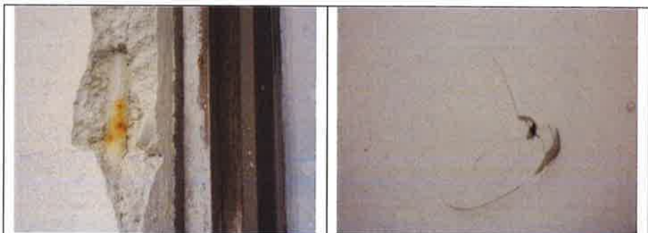
Utvendig frilagt armering som er utbedret – skaden kommet tilbake.
