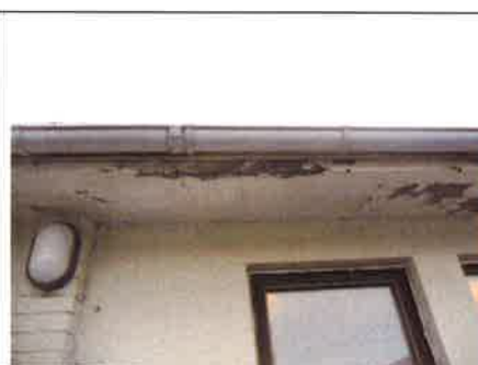
Frilagt armering oppunder tak-ut-stikket
