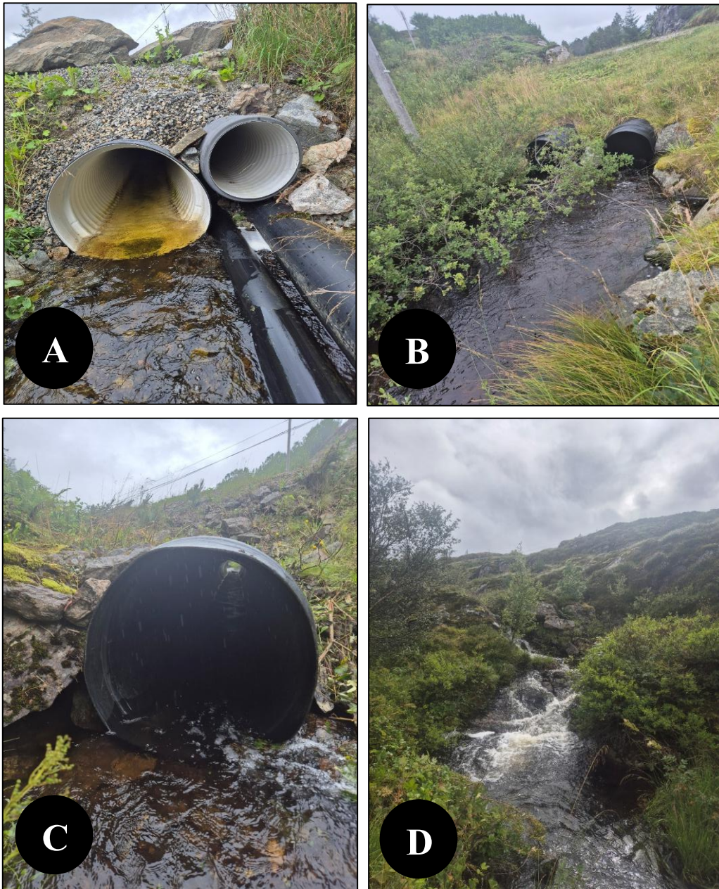
Figur 1. Bekkelukkinger og vandringshindre i bekken mellom Tuvnesvatnet og utløp til sjø. A) Rør mellom segment 6 og 7. B) Rør mellom segment 11 og 12. C) Rør mellom segment 17 og 18. D) Naturlig temporært vandringshinder i segment 18.
